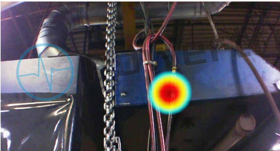
Imagem obtida com o Imageador Acústico Industrial ii900 de um vazamento de ar em um ambiente industrial.
